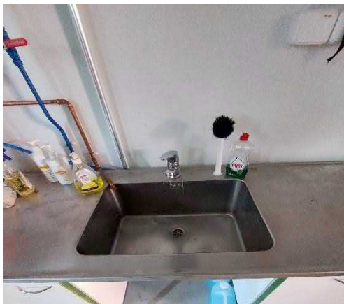
Kiinteistön laajennusosan pesuallashana.
