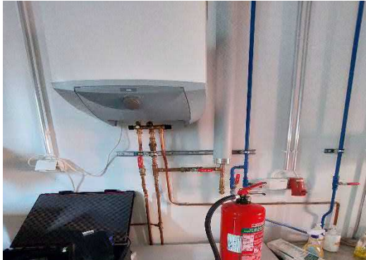
Kiinteistön laajennusosan lämpimän käyttöveden varaaja ja käyttövesijohtoja.
