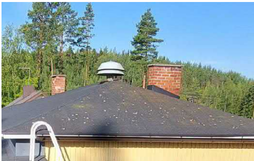
Kiinteistön alkuperäisen rakennusosan painovoimainen ilmanvaihtohormi vesikatolla.
