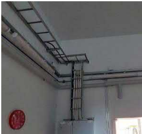
Tikashylly ja ripustuskiskoa kalustohallissa
