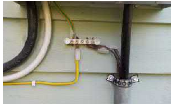
Maadoituskisko pääkeskuksen yhteydessä
