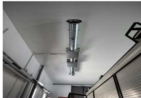
Kiinteistön laajennusosan poistokanavisto.
