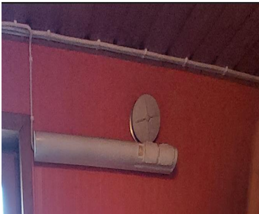
Alkuperäisen rakennusosan kylpyhuoneen korvaus-ilmaventtiili
