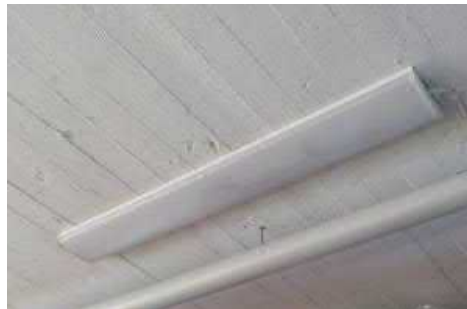
Valaisin vanhemmassa kalustohallissa
