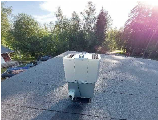
Kiinteistön laajennusosan huippuimuri PK01.
