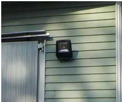
LED-valonheitin seinään asennettuna
