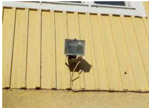
Halogeenivalonheitin seinään asennettuna
