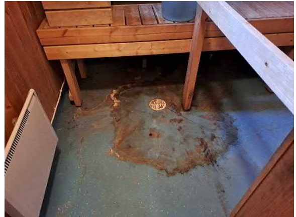
Vesi lammikoituu saunan lattialle
