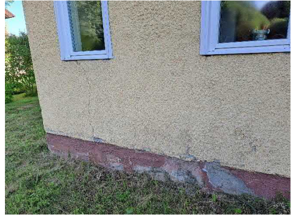
Alkuperäisen osan rappaus- ja sokkeliosissa vaurioita
