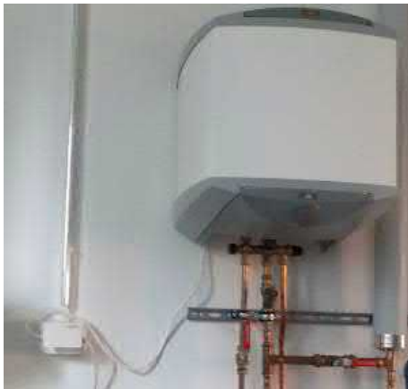
Lämminvesivaraaja kytkettynä pistorasiaan
