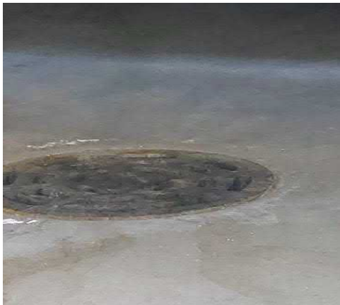
Kiinteistön laajennusosan hiekan/öljynerotuskaivo
