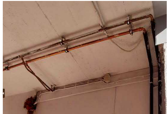
Kiinteistön alkuperäisen rakennusosan saneerattuja käyttövesijohtoja.
