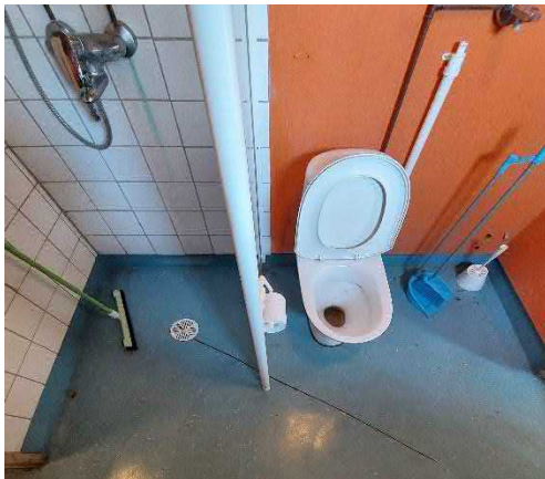
Kiinteistön alkuperäisen rakennusosan pesuhuoneen vesikalusteet.
