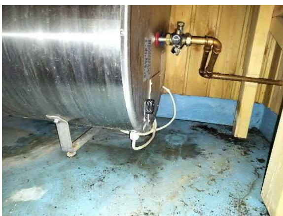
Kiinteistön alkuperäisen rakennusosan lämminvesivaraaja ja vuotava putkiliitos.
